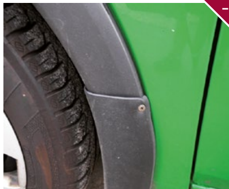
Nieprawidłowe zamocowanie któregośkolwiek z elementów wyposażenia zewnętrznego nadwozia lub uszkodzone uchwyty mocujące.
